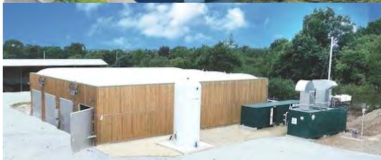
Exemple de site de méthanisation/biogaz
