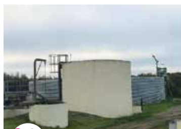
Station d'épuration Damparis
